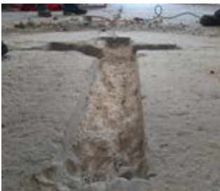
Daños en piso
